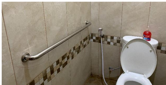
Gambar 41 Handle bar di toilet disabilitas
